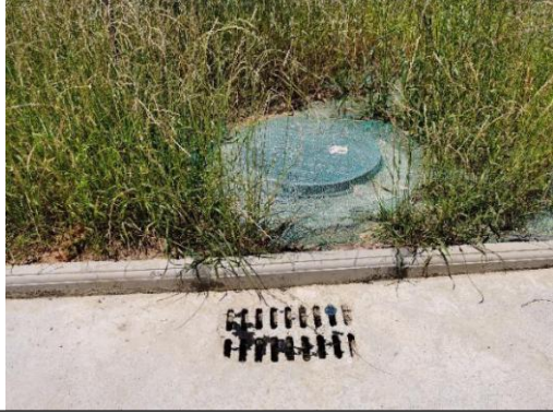
升压站站内排水沟及沉沙井
