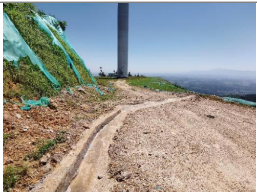
20#风机路面导水槽
