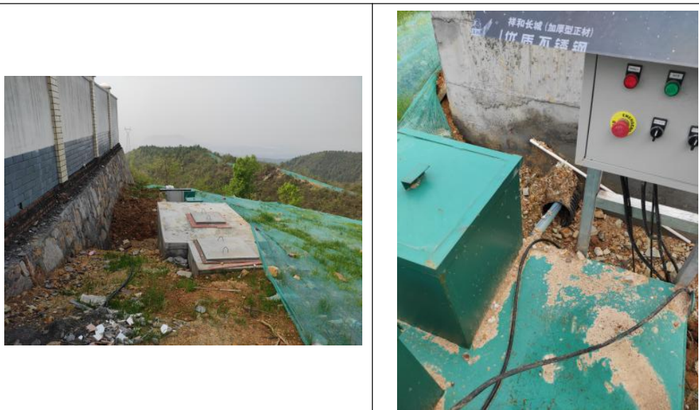
升压站一体化污水处理系统及绿化回用
