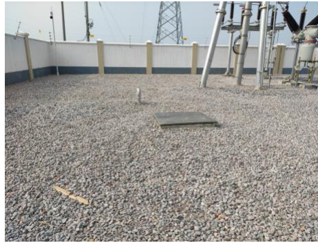
站内地埋式事故油池外观
