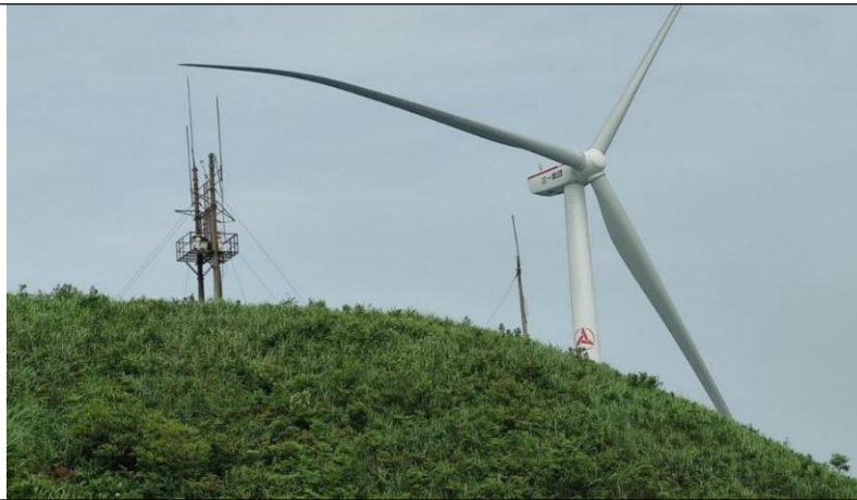
场内通信设施现状
